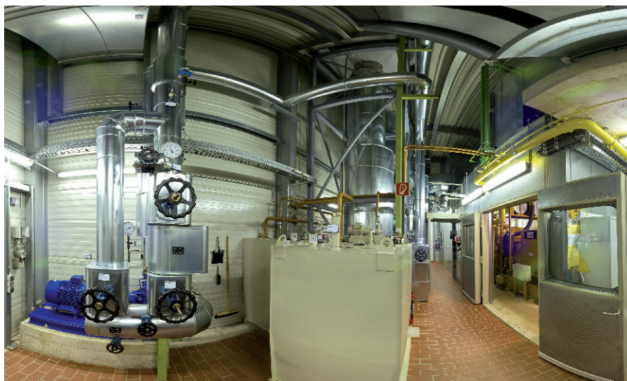
Blick ins Innere eines 2-MW-Blockheizkraftwerks der Stadtwerke Lemgo. Seit Ende 2005 wurden fünf Anlagen in baugleicher Form in Betrieb genommen.
