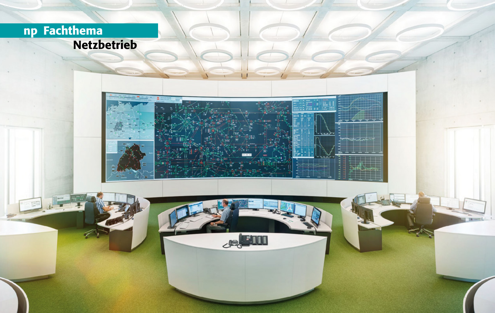
Bild 1. Die Hauptschaltleitung in Wendlingen
